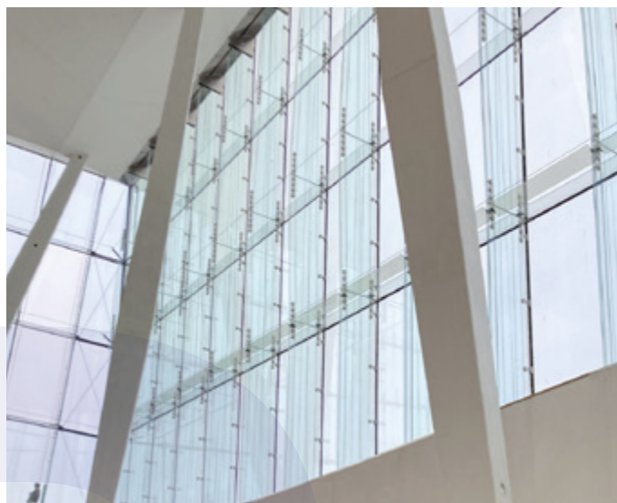
I operaen i Oslo, er der monteret vandrette glasfinner for at hinder, at kuldene faldet fra facaden giver ubehag i foyeren. Foto: Pia Israelsen
